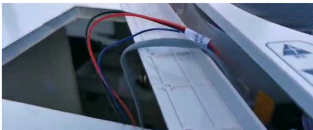
Провода питания в зоне внутренней рамки
